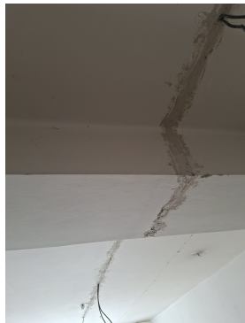
Praskliny a opravy stropu: před finálním nátěrem je nutné určit příčinu vady.
